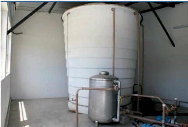
Tanque de tratamento biológico de efluente (Viação Nossa Senhora do Amparo Ltda)
